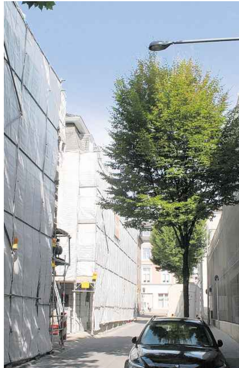
Gut und vor allem sicher verpackt: Das Haus der Evangelischen Kirche hinter dem Parkhaus Jesuitenstraße (rechts) versteckt sich hinter einem Bagerüst. Die Fassade muss saniert werden. Fotos: Thorsten Karbach
